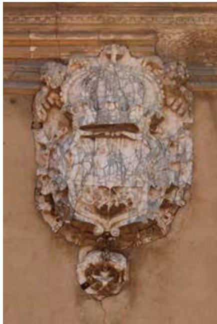
Figura 04: Escudo de Felipe IV, labrado en mármol blanco, situado en la fachada del antiguo convento de clausura. Sus numerosas fisuras y procesos de microkarstificación, derivarán en la pérdida de la volumetría original -ya iniciada en el ángel tenante de la derecha y otras zonas- si no se actúa de forma urgente.
