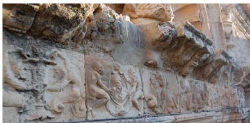
La desaparición de la cornisa ha acelerado el deterioro
