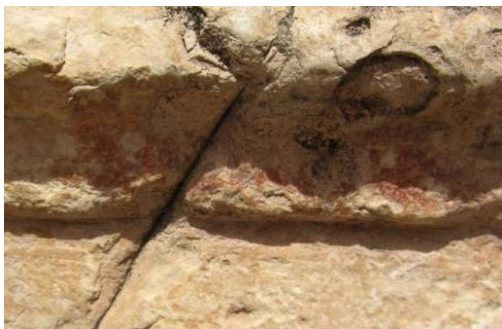
Existencia de numerosas grietas sobre la portada
