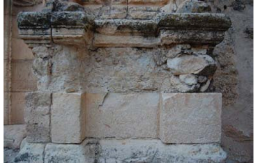
Pérdida de elementos estructurales
